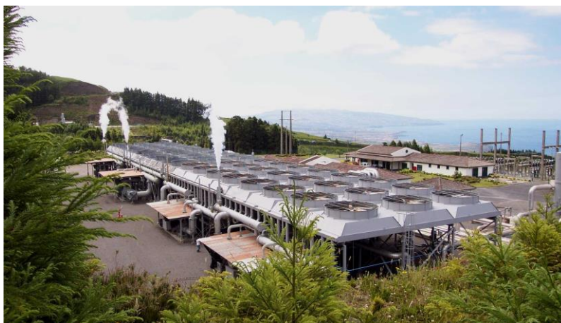
Figura 4 – Central Geotérmica da Ribeira Grande
