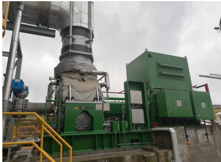
Figura 7 – Grupo gerador da CGPA.
