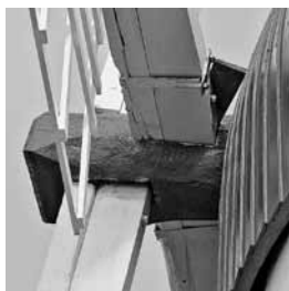
Fig. 19 – 2006 Jan. Mastro curto com cruzetas e painéis.
