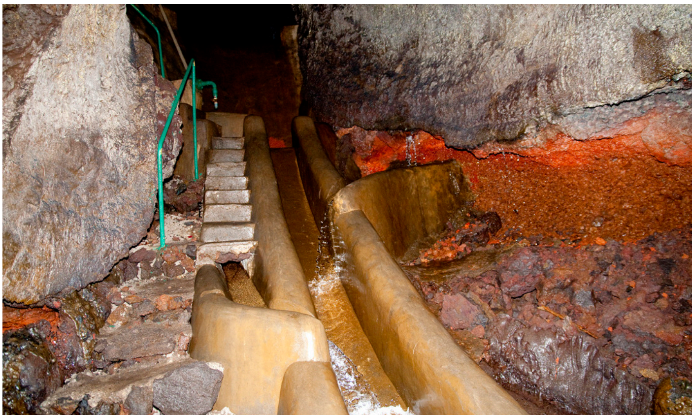
Nascentes da Furna da Água e Furna do Cabrito Estações de Tratamento de Água do Cabrito e da Fonte da Telha. Colaboração dos Serviços Municipalizado de Angra do Heroísmo, Câmara Municipal de Angra do Heroísmo.
