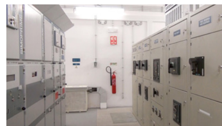
Subestação - Sala de quadros de Média Tensão
