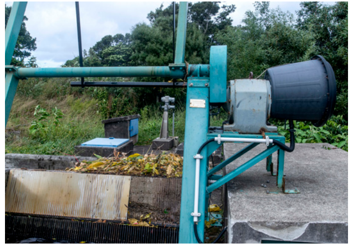
Limpa-grelhas da Câmara de carga
