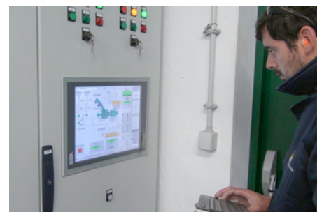
Quadros de comando e controlo dos grupos hídricos
